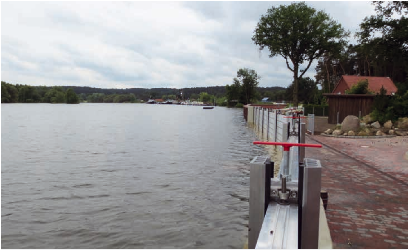
Hochwasserschutz in Alt Garge: Ein Deich und eine 240 Meter lange Hochwasserschutzwand schützen jetzt den Ort wirksam vor Hochwasser.
