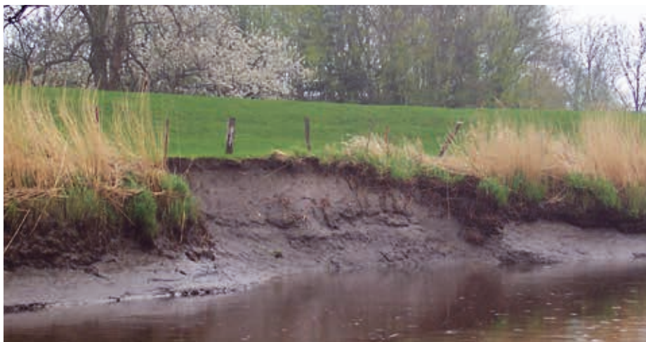
Uferabbruch an der Oste – hier ist schnelles Eingreifen gefragt, damit der direkt am Fluss liegende Deich nicht beschädigt wird.
